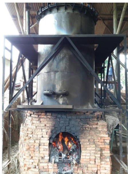
Gambar 1. Instalasi mesin penyuling minyak serai wangi
